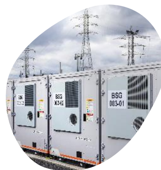
Energiespeicher Kairos - Belgien 25 MW/100 MWh - Großbatteriespeicher mit LFP Lithium-Ionen Batterien Inbetriebnahme Februar 2023
